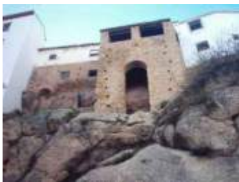
Detalle de arco para salvar las fisuras. Sector Este
