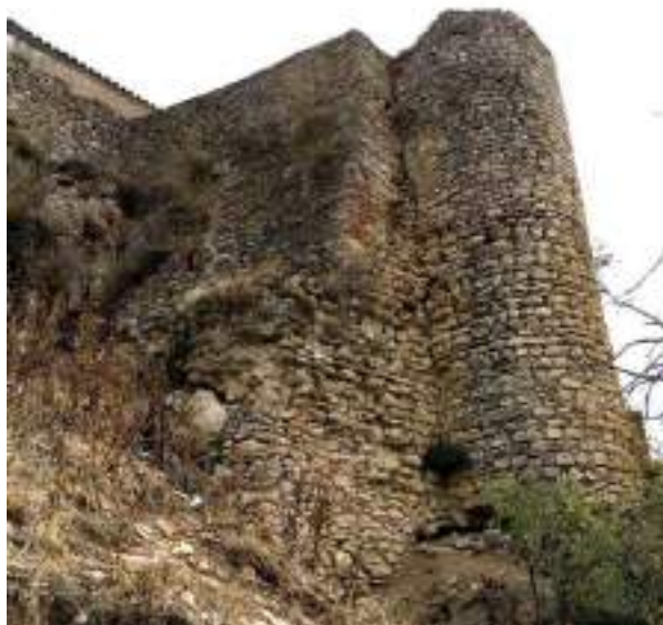
Torre del sector Alcazaba-Castillo, con la presencia de dos tipos de mampostería, correspondientes a dos fases constructivas sucesivas (Plan Director Murallas)
